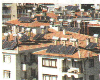
图 11-5-6 架设在屋顶的太阳能集热器
